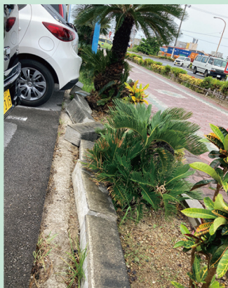
なかなか修繕されない縁石の破損
